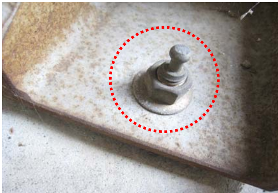
写真1 あと施工アンカーの打込み不足の例
