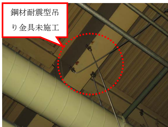
写真2 鋼材耐震型吊り金具が未施工の例
