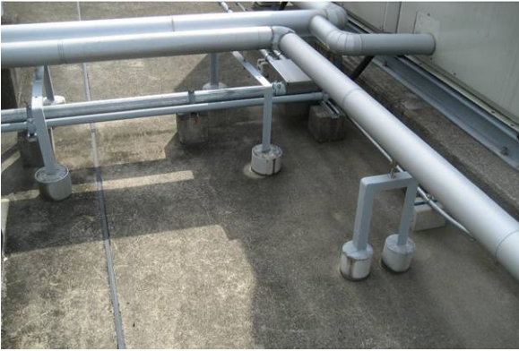
写真5 横引き配管の移動・転倒防止対策未実施の例
