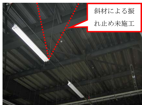
写真3 鉛直吊り材のみで振れ止め未施工の例
